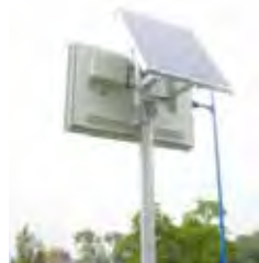
Viasis sur mât avec panneau solaire
